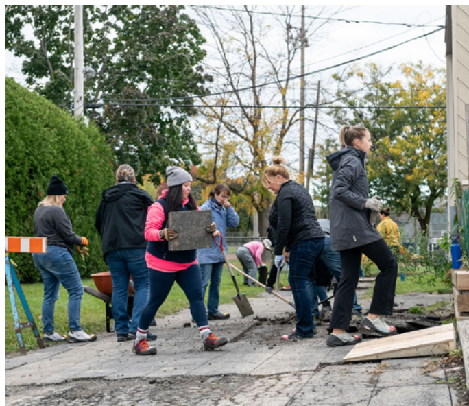
Des bénévoles s'affairent à enlever l'asphalte à la main lors du projet « Sous les pavés » organisé par la Ville de Boisbriand.
